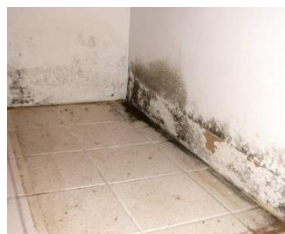
beschimmelde muren in de woning
