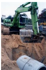
bij rioolvervanging wordt het scheiden van schoon hemelwater niet afgewogen
