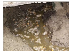
riolen verkeren in een slechte technische staat
