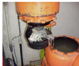
gemalen verkeren in een slechte technische staat
