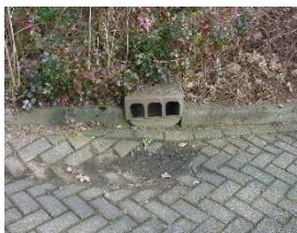
water kan niet goed via kolken afstromen
