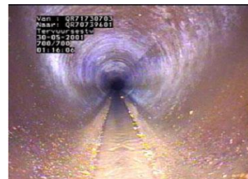
riolen verkeren in een goede technische staat
